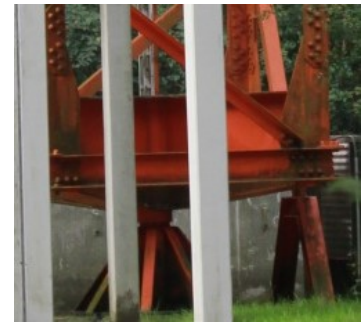
Verankerung des Sendemastes in Kirchlinteln
