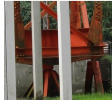
Verankerung des Sendemastes in Kirchlinteln
